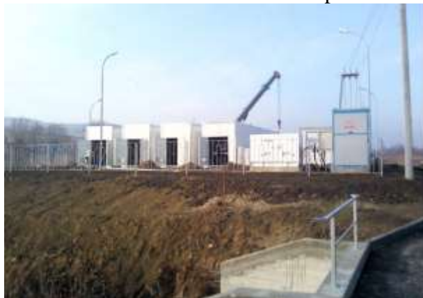
Stația de epurare din or. Călărași
