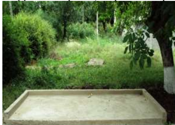
Platforme pentru colectarea DMS
