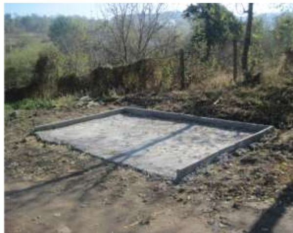
Platforme pentru colectarea DMS
